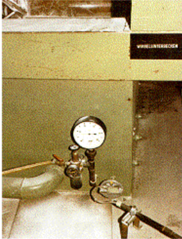
Bild 25: Pulverablagerungen an einer Wirbelsinteranlage
