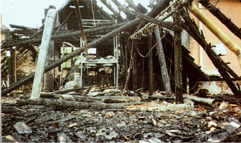
Bild 5: Absauganlage und Modellboden durch Brand zerstört
