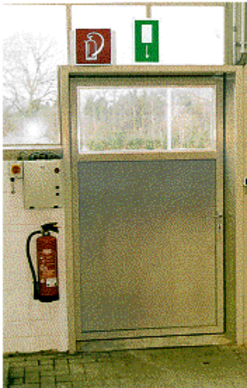
Bild 22: Notausgang mit Kennzeichnung und Feuerlöscher
