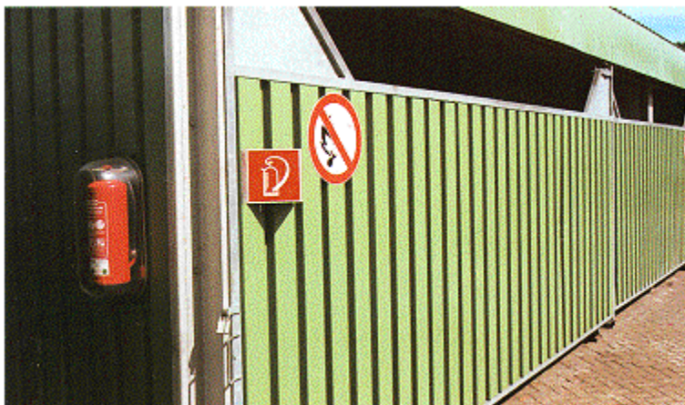
Bild 35: Oberirdische Lagerung leicht entzündlicher Gase
