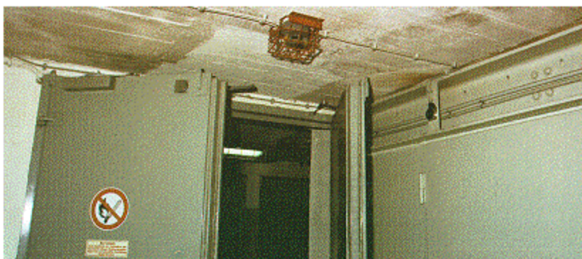
Bild 52: Meldergesteuertes Türmagnetsystem für selbstschließende Tür mit Schließfolgeeinrichtung als Brandabschluß für einen Raum zur Lagerung brennbarer Flüssigkeiten
