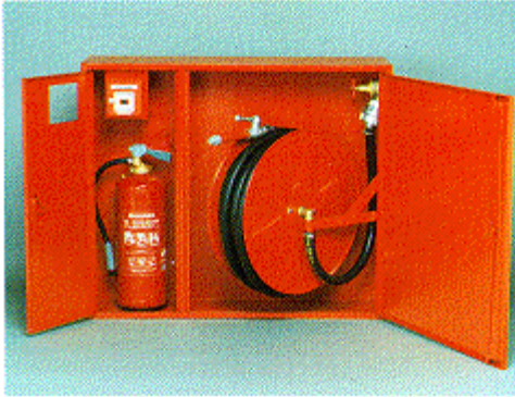
Bild 64: Wandhydrant mit formbeständigem Schlauch, Pulverlöscher und Feuermelder
