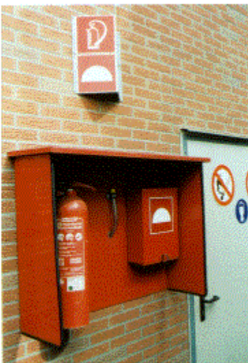
Bild 65: Feuerlöscher und Löschdecke im Betrieb
