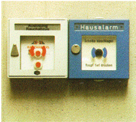
Bild 53: Druckknopfmelder für Hausalarm und zur Ansteuerung von Rauch- und Wärmeabzügen
