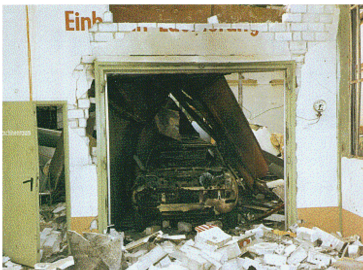
Bild 1: Zerstörte Lackiererei nach Entzündung von Lösemitteldämpfen
